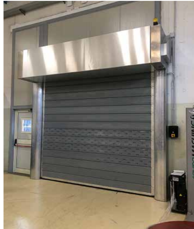
slika 28. Spiralna brza vrata sa termo panelima debljine 42 mm
