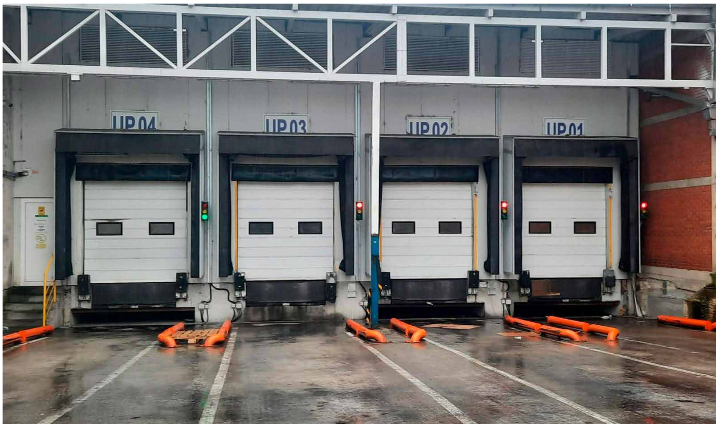
slika 10. Dihtung zavese (Dock Shelters) sa metalnim uvodnicima za točkove vozila. Logistički centar
